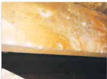
Skimmelsvamp i tagkonstruktionen som følge af forkert udført efterisolering.
